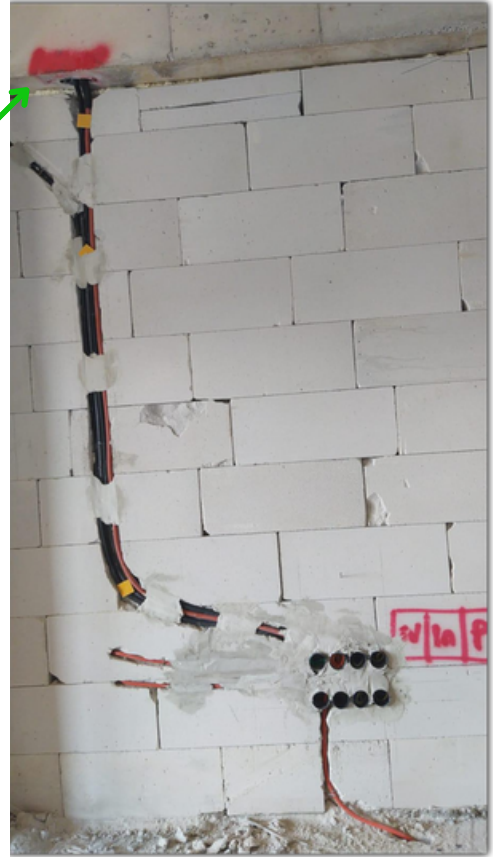
Şekil 3.4: Kiriş buatı kullanılmış bir duvarın görüntüsü. Boru ve kablo hattı ek yapılmadan tv-priz ünitesine çekilmiş
