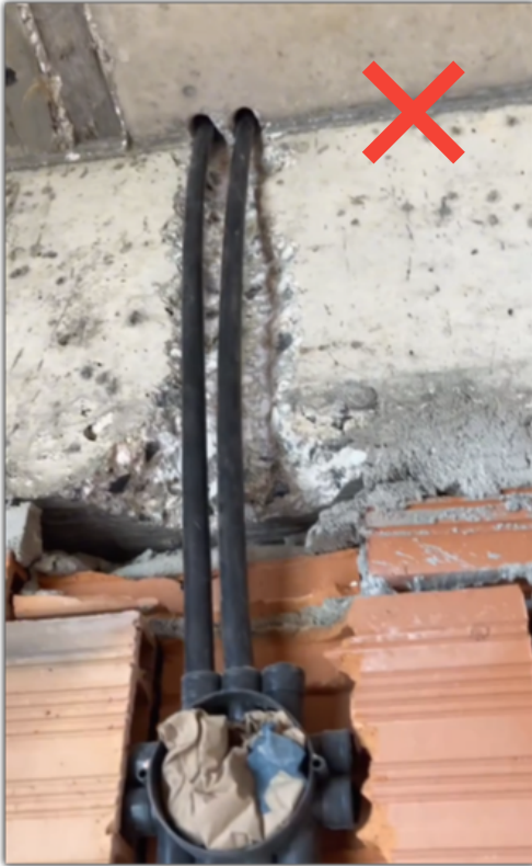
Şekil 4.2 : Kiriş buatı kullanılmayan tesisatta yapı güvenliği göz ardı edildiği gibi yoğun bir işçilik söz konusu olur. Beton matkap ile kazılarak kanal açılmış
