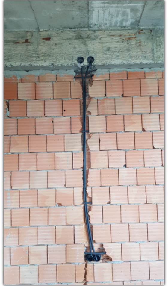
Şekil 2.2: Kiriş-duvar birleşiminde tesisat borularının geçişi için yapılan ve yapısal bütünlüğü bozan standart kırım işlemi.
