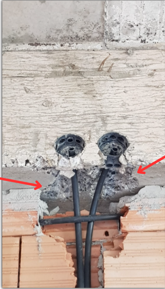
Şekil 2.1: Geleneksel yöntemde buat montajı için taşıyıcı elemanda ve duvarda oluşturulan aşırı tahribat ve kalitesiz işçilik.
